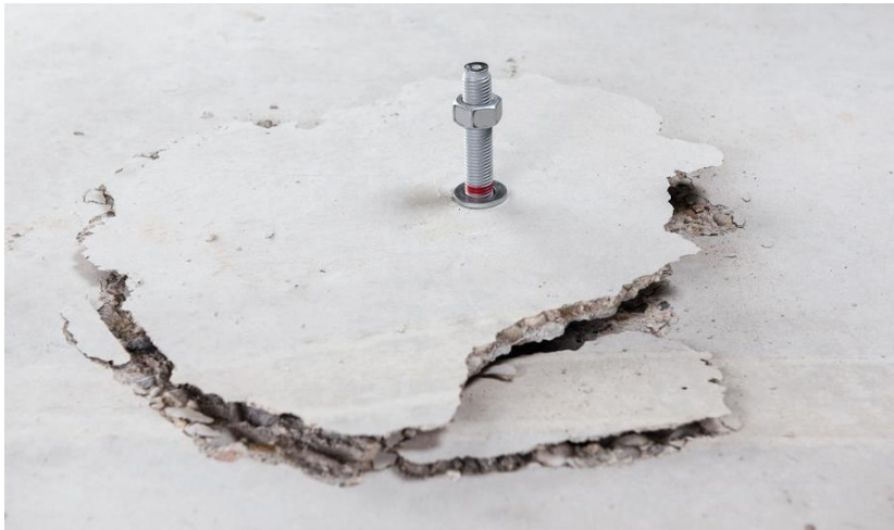
Betonausbruch unter Zugbelastung
