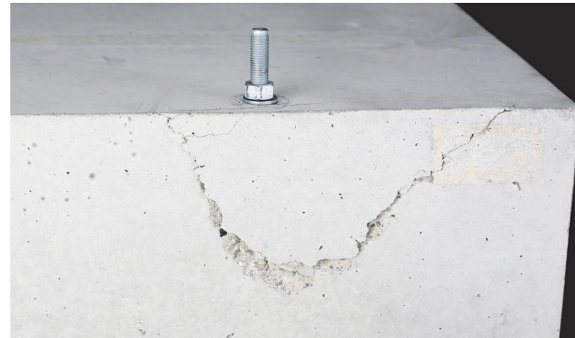
Betonkantenbruch bei Querbelastung
